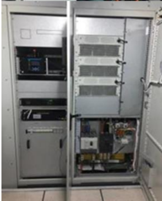
Foto do sistema instalado no Campus de São Paulo, unidade Butantã, da USP.
